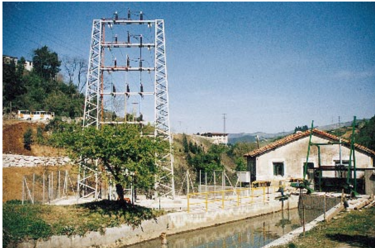
Foto 6. Canal de derivación y transformador C.H. Barrena-Berri (Cortesía de Saltos del Deva, S.R.L.)
