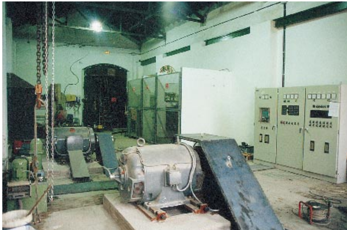
Foto 2. Interior de la C.H. Irauregui, periodo de obras (Cortesía de Irauregui, S.L.)
