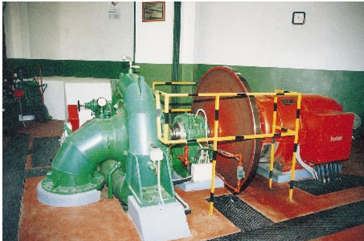
Foto 5. Grupo turbina - generador C.H. Bertxin (Cortesía de C.H. Bertxin, S.A.)
