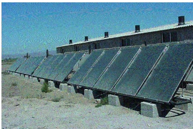
■ Apoyo al Sistema de calefacción por suelo radiante en granja porcina. Lorca
