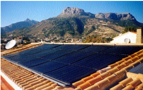
■ Calentamiento de piscina con colectores de polipropileno en tejado
